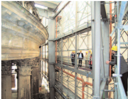
Umwelteinflüsse haben die 160 Säulen der Kolonnade schwer geschädigt.
